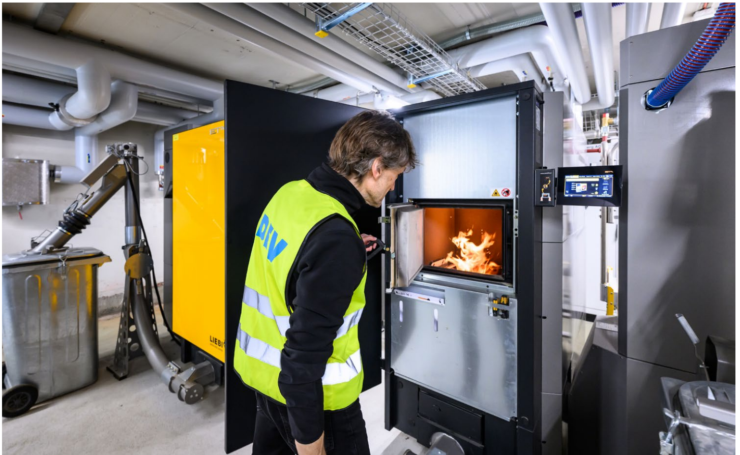
Unten: Die ADEV betreibt mehr als zwei Dutzend Wärmeeinheiten. Dabei setzt das Unternehmen wenn immer möglich auf die Nutzung von Abwärme oder Abfällen sowie – wie hier im Wärmeverbund Seltisberg – auf lokales Holz.
